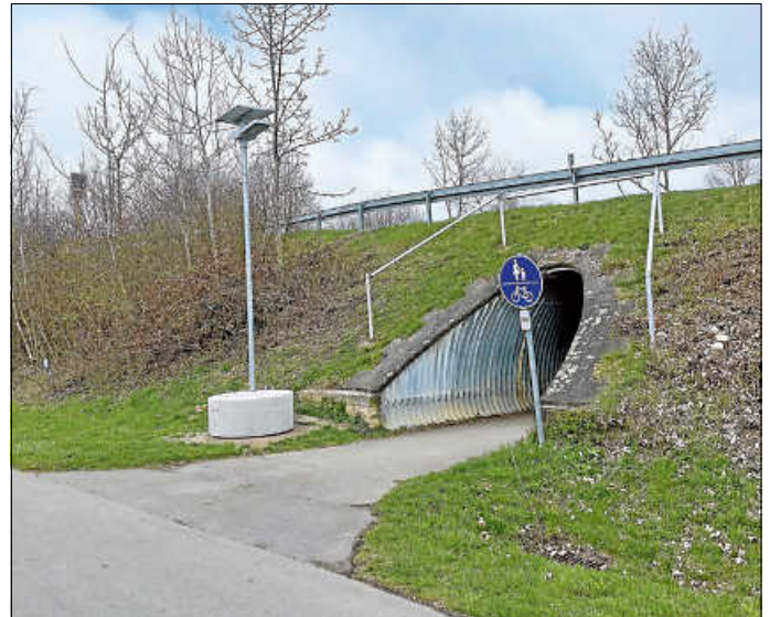
Mittels Sonnenenergie: Beleuchtung der Tunnelleingänge
